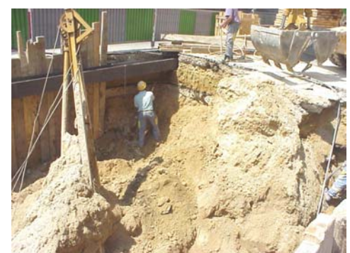
Dégâts en surface suite à l'effondrement
