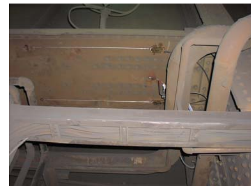
Extensomètre optique en sous-face de poutre de voie de roulement
