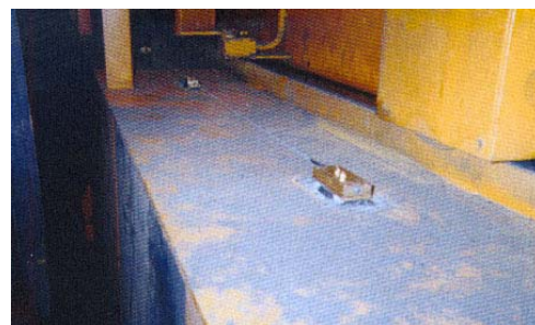
Corde Optique sur la semelle supérieure de la poutre du pont, déterminant sa contrainte normale
