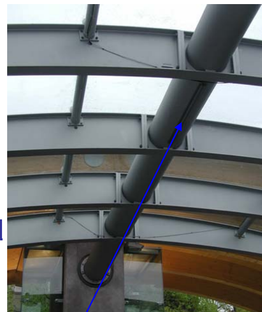
Corde Optique sous poutre
